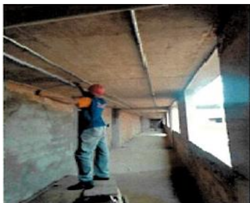
Detalhe Instalações Elétricas
